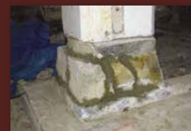
Složitý detail zpevnování paty piliře nosícího klenbu stáje znamenal nutnost opatrného přístupu, kdy byla vzájemně porovnávána stránka statická s památkovým hlediskem.
