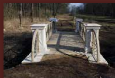
Mostek na Vosouši – k věrohodnosti přispěla možnost přesné rekonstrukce piliřků zábradlí podle na místě nalezeného torza původního prvku.
